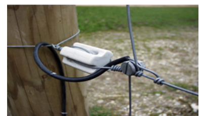
Isolator und Drahtverbindungen
